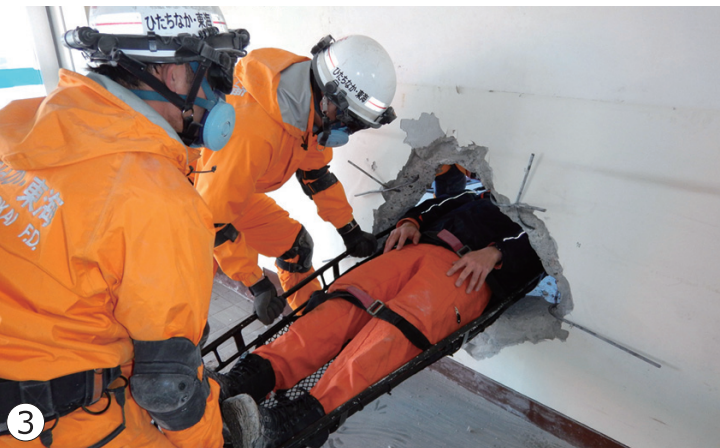
ブリーチング訓練 (①、②鉄筋コンクリートの壁を破壊し進入・退出路を確保、③要救助者の救出状況)
