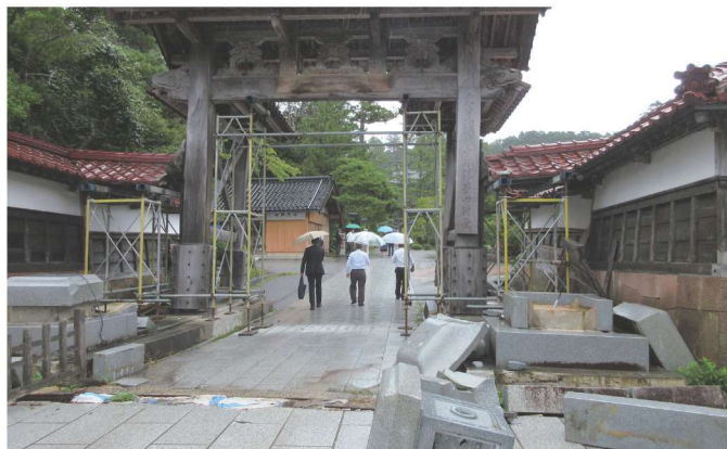
大本山総持寺祖院の被害状況視察
